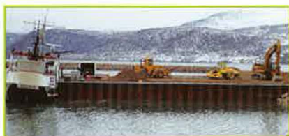
Avec le concours d'une de ses compagnies sœurs Almiq Contracting Ltd ainsi que McNally Corp., le Groupe LFL a réalisé, l'an dernier, d'importants travaux de conception et de construction pour le quai Pangnirtung, un contrat que lui avait alloué le gouvernement du Nunavut.
